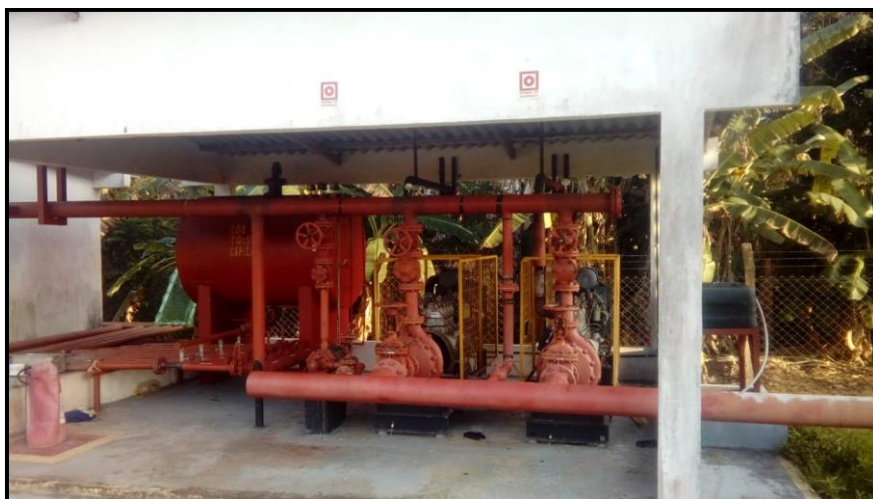
Foto 2. Casa de bombas do combate a incêndio.
